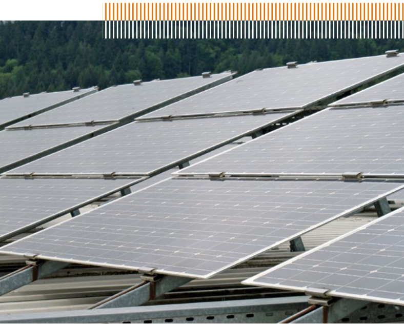
Die Fördermöglichkeiten bei Photovoltaik sind vielfältig.
