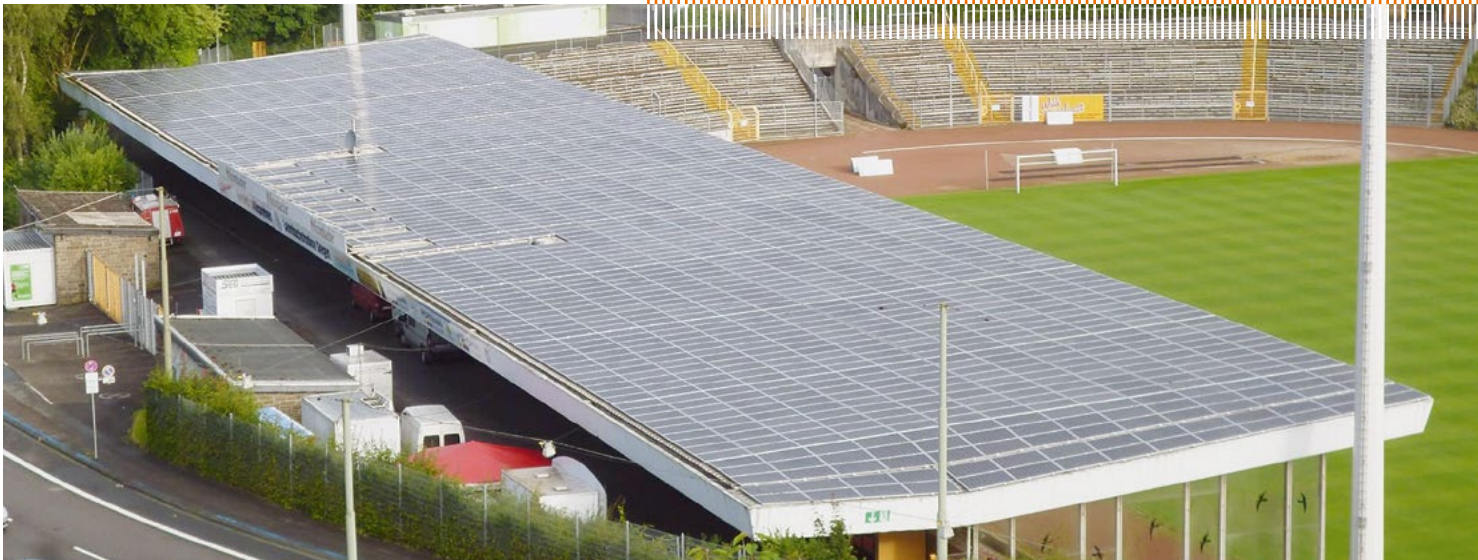
Die Photovoltaik-Anlage auf dem Tribünendach des Leimbachstadions produziert etwa 480.000 Kilowattstunden Strom im Jahr.
